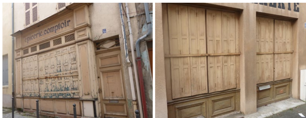
Devantures anciennes qualitatives. A gauche, une devanture en applique, à droite, une devanture en feuillure.
