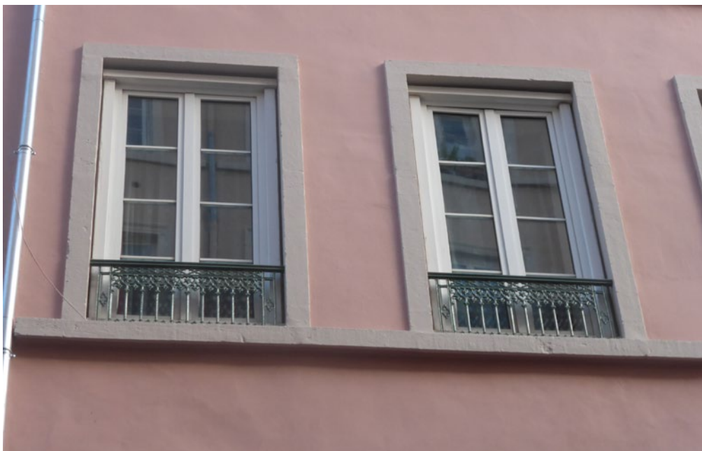
En haut, une façade isolée par l'extérieur. Le problème du raccordement avec le rez-de-chaussée demeure. En bas, des fenêtres posées «en rénovation» : sans dépose du châssis. Ce procédé doit être évité.
