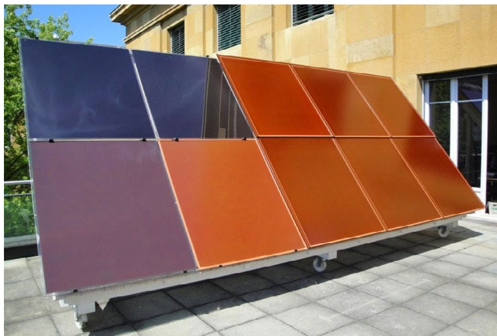
Les champs solaires paraissent peu pertinents à Saint-Saturnin. Les panneaux solaires individuels font en revanche des progrès constants d'intégration.
