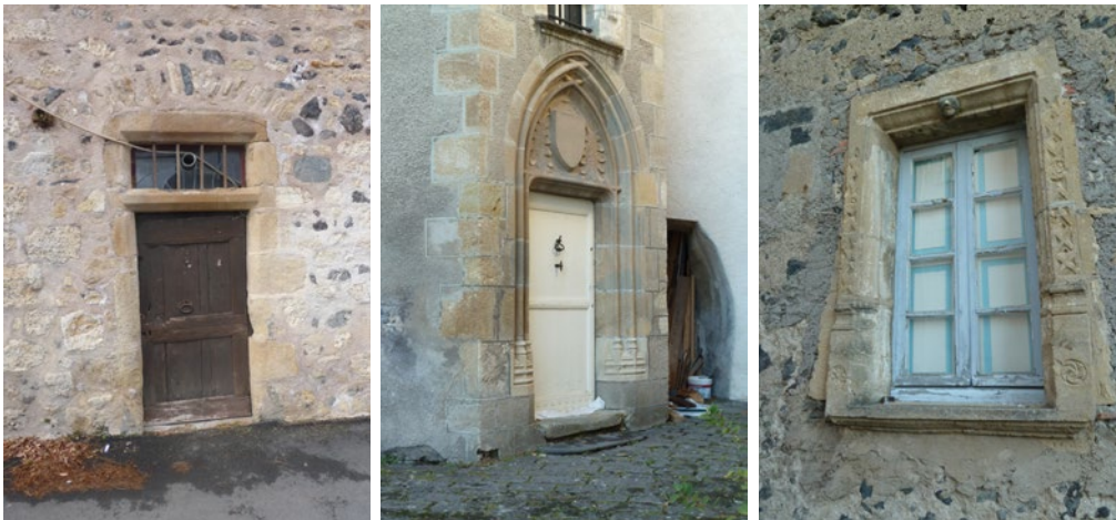
Les éléments en pierre de taille (encadrements, modénatures, décors et détails) doivent être conservés et restaurés s'ils sont dégradés.
