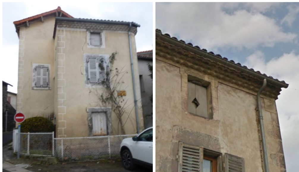
En haut : enduit à pierres vues. Les joints ne sont pas creux et viennent «mourir» sur la surface assisée des pierres. En bas : deux décors peints, qui valorisent les mêmes éléments : chaines d'angles, encadrements de fenêtres, filets soulignant les génoises.
