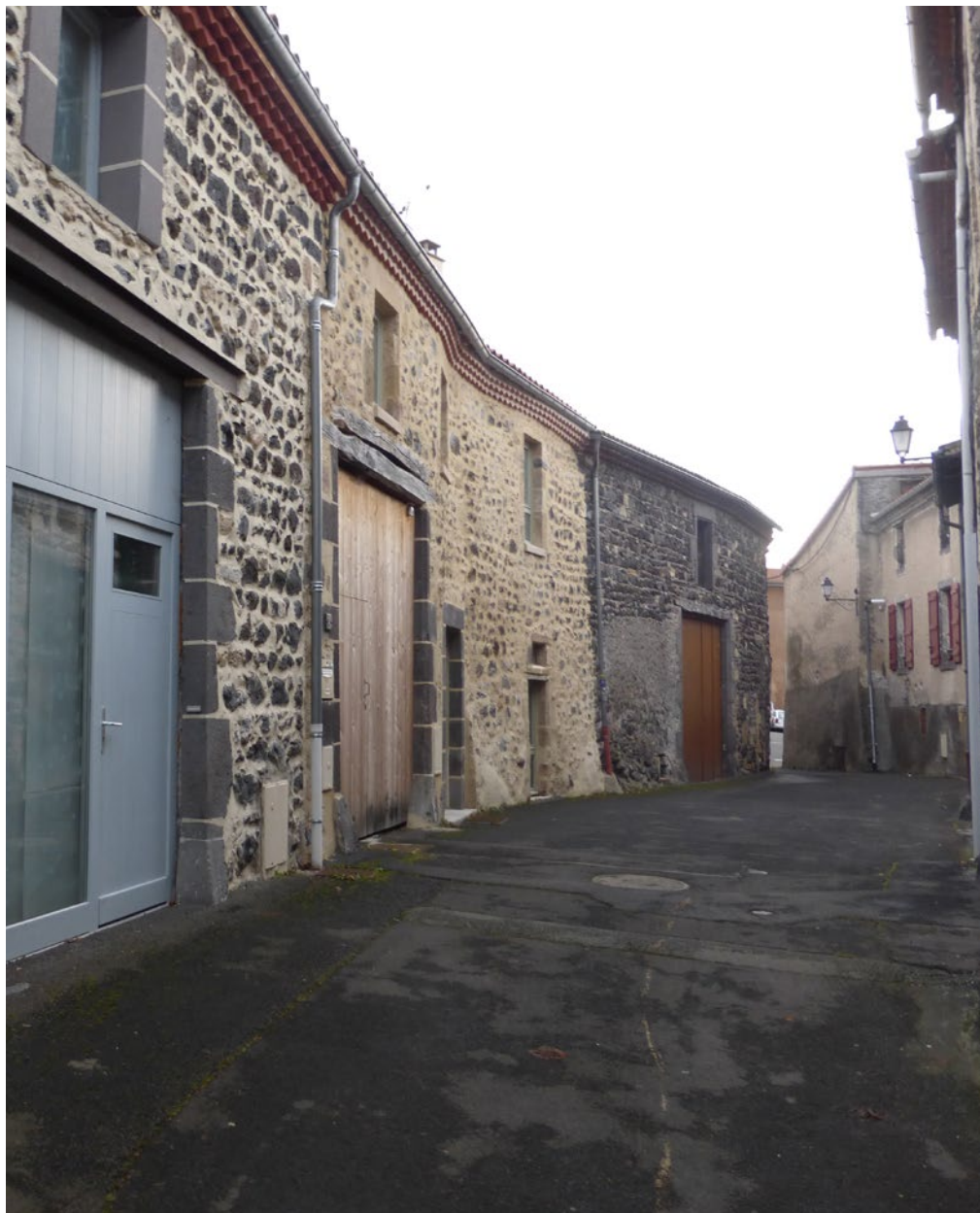
L'air froid circulant entre les interstices des pierres, même des enduits laissant les pierres apparentes ont un impact thermique non négligeable. Les joints doivent être correctement chargés de mortier de chaux.
